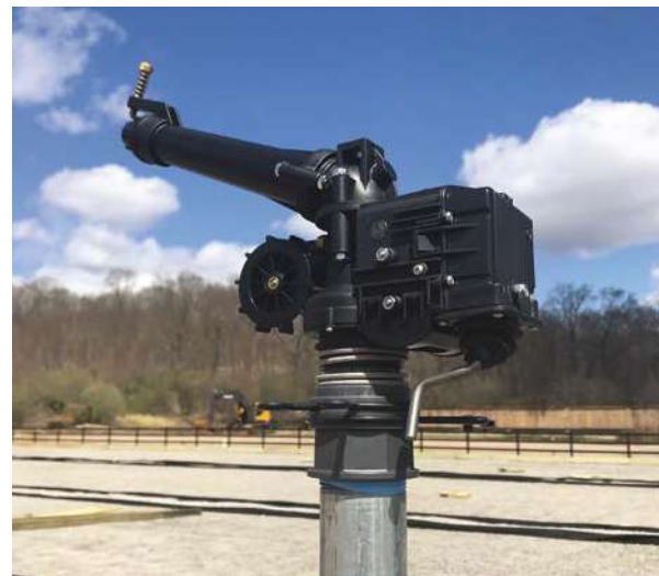
ST-1200-BR Getrieberegner installiert
